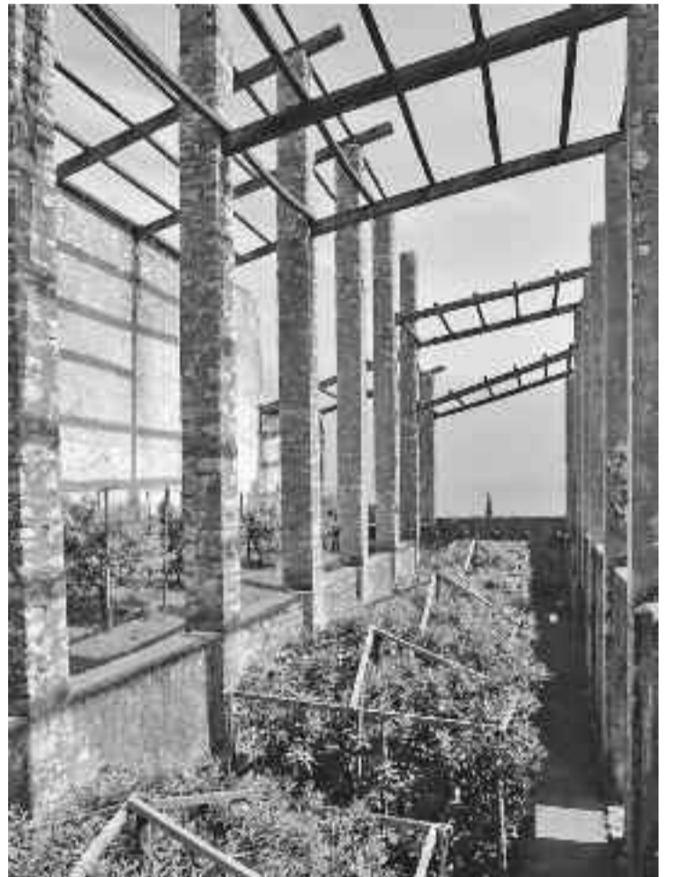
Via Crocefisso: una limonaia, ancora strutturalmente integra, aperta al pubblico per Giardini d'Agrumi.
