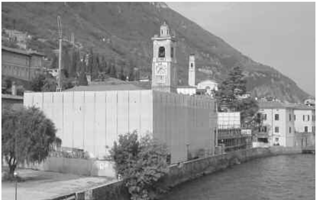
La Società Lago di Garda, nascosta dalle impalcature del cantiere avviato nel 2009.
